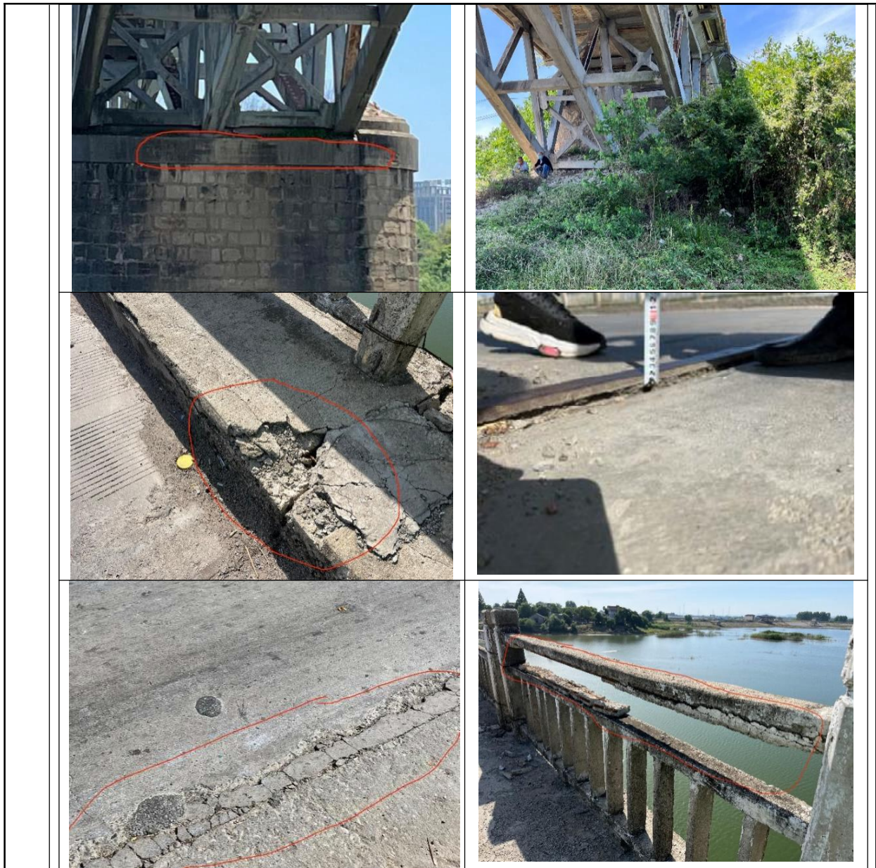
图 2-2 杜坞大桥老桥梁现状病害照片
